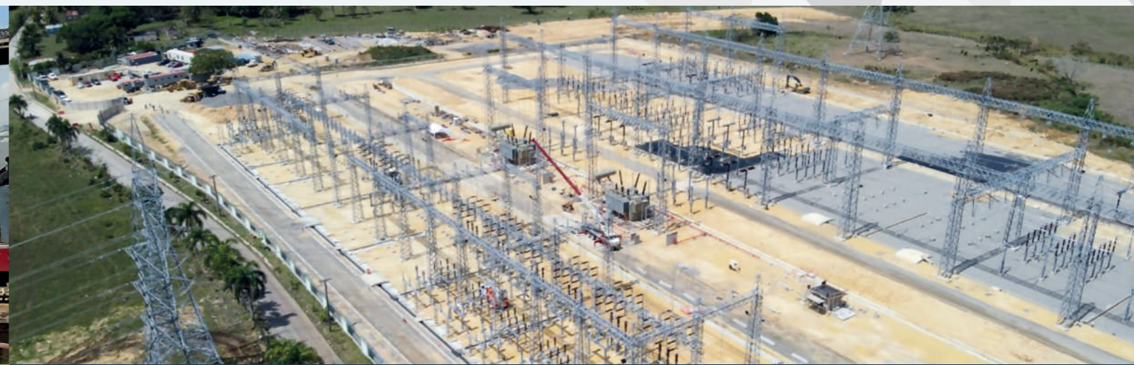
Diseño, estudio y control de calidad de subestaciones eléctricas.
